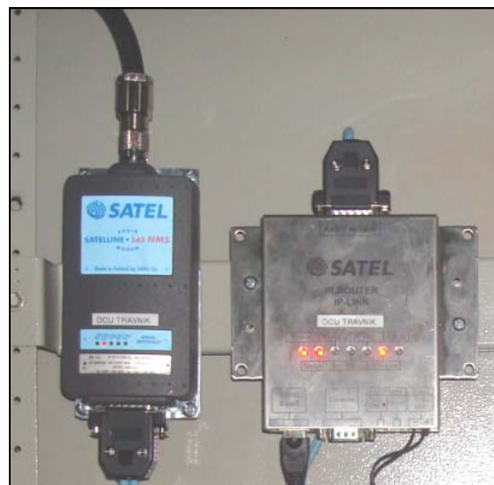
Instalacija Sateline 3AS NMS radijskog modema i IP-LINK uređaja na lokaciji DCU Travnik
