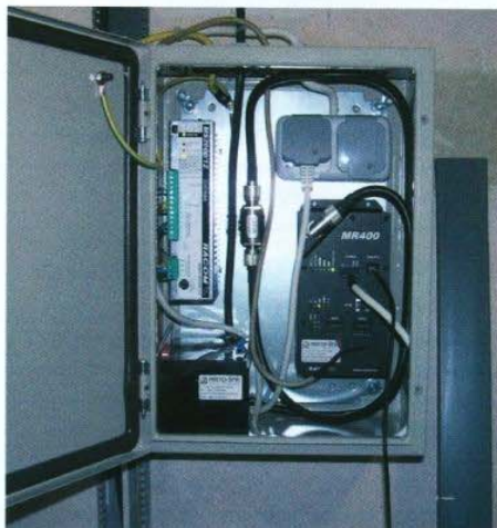
Instalirani MR400 radijski modem s pripadnim sustavom napajanja zajedno s baterijom za 12 sati autonomije rada i zaštitom od atmosferskih pražnjenja
